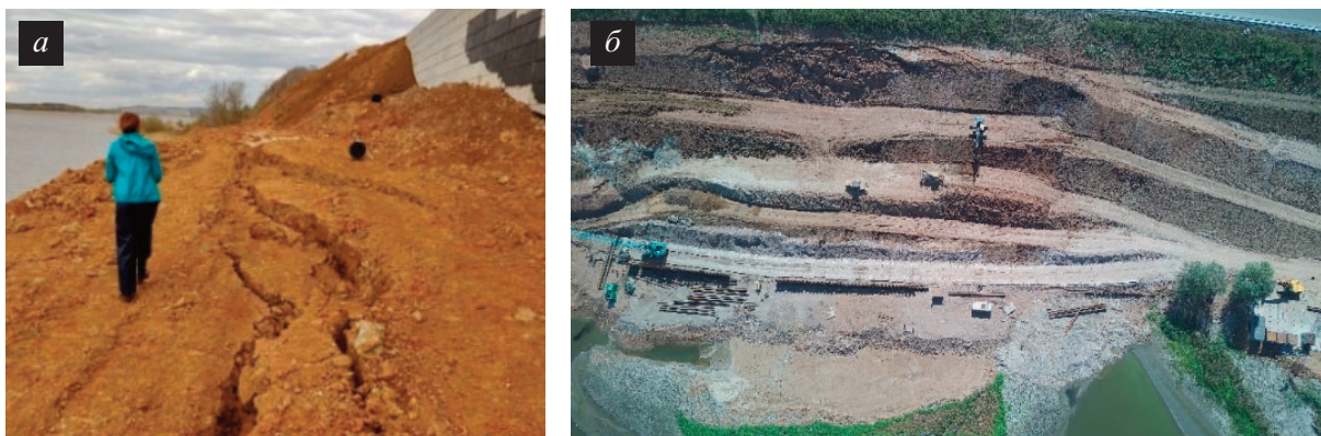
Рис. 2. Оползневые трещины на упорной берме 26.04.2023 г. (а) и работы по созданию шпунтовых стенок, террасированию откоса (б) 02.08.2023 г. [1]
