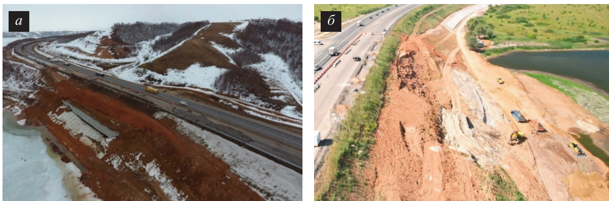
Рис. 1. Вид на участок автодороги в апреле (а) и июле (б) 2023 г.
