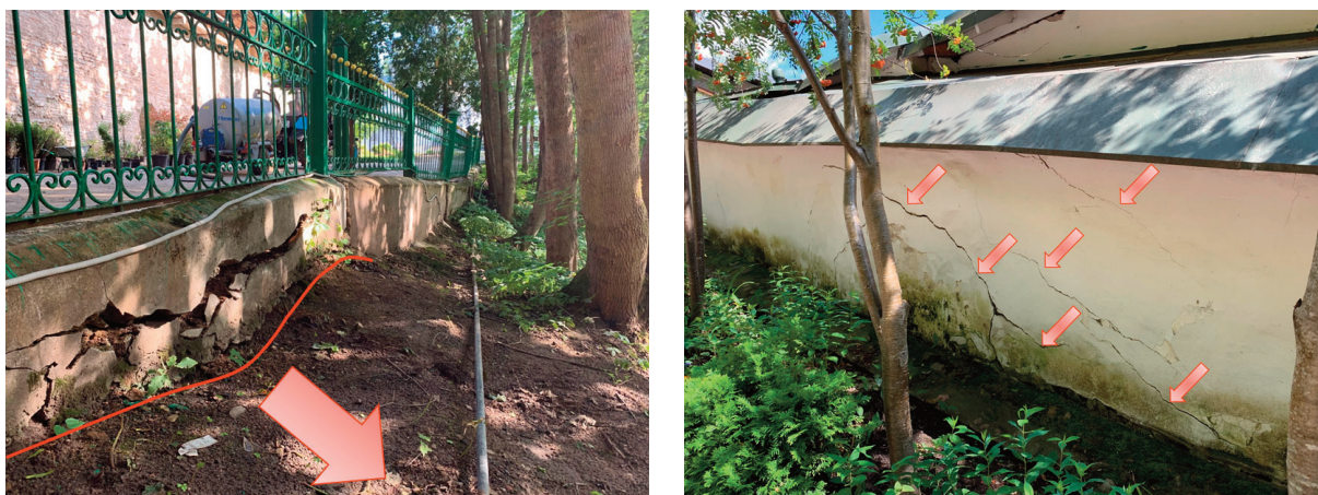
Рис. 1. Развитие оползня вблизи Тайловской башни и трещины в сооружениях, расположенных вдоль «Кривавой» дорожки
